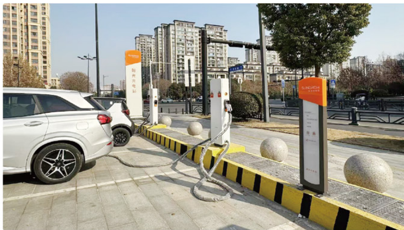
安徽涡阳喜堂宴会中心充电站 Anhui Guoyang Xitang Banquet Center Charging Station
